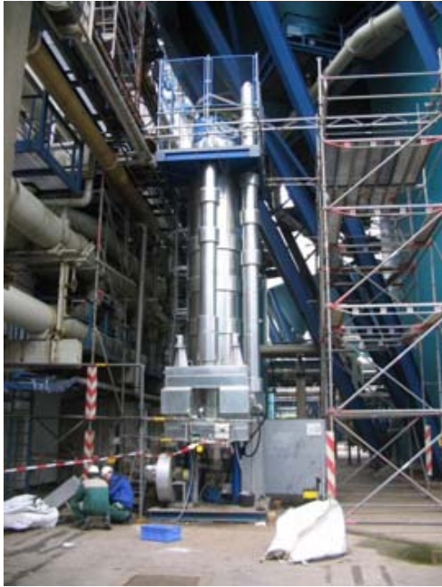
a) Aufbau der Pilotanlage (1)
