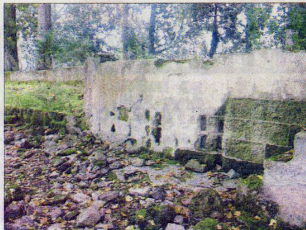
Um das Ufer naturnah gestalten zu können, werden die NABU-Mitarbeiter die alte Schutzmauer abreißen. ■ Foto: NABU
