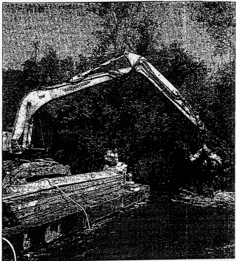
Baggern für die Natur: Dort, wo die Uferbefestigungen aus der Zeit der Rhein-Kanalisation nicht mehr gebraucht werden, sollen sich auf Sand- und Kiesbänken wieder die heimischen Tier- und Pflanzenarten ausbreiten. Bild: Proßwitz
