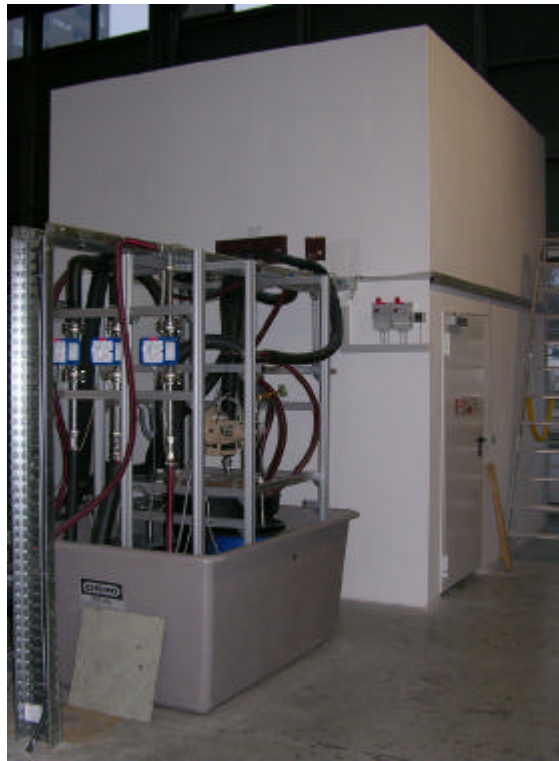
Abbildung 25: Separater Maschinenraum und Versorgungskreisläufe
