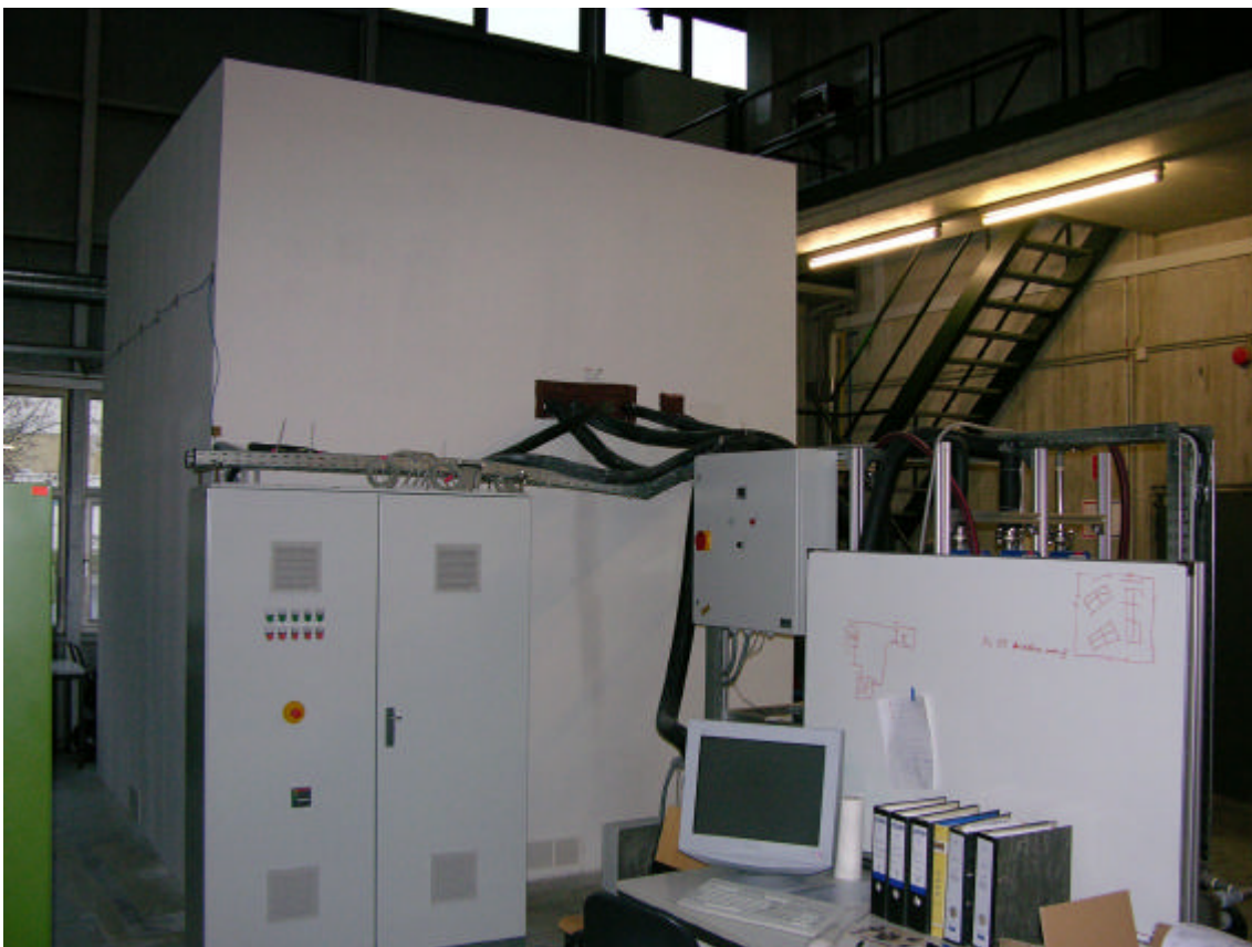
Abbildung 26: Separater Maschinenraum und Messwarte
