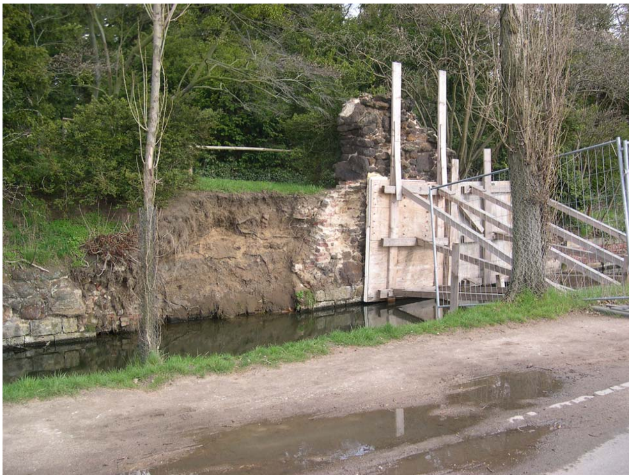
Durch Wasserdruck und Unterspülung der Fundamente stürzte die aus Raseneisenstein bestehende Mauer ein. Foto Annette Scholtka
