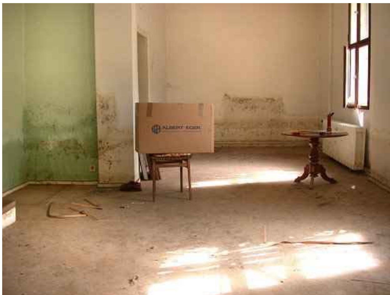
Luisium, Eyserbeckhaus nach Abzug des Hochwassers im September 2002. Zu sehen ist, wie hoch das Wasser mehrere Wochen lang im Gebäude stand. Foto Heinz Fräsdorf
