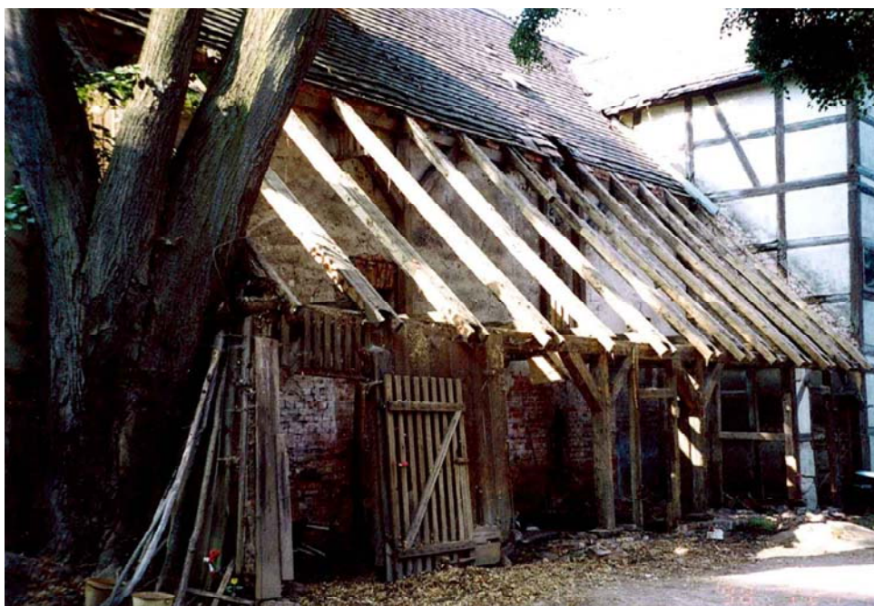
Ein direkt in einem Fundament gewachsener Großbaumes musste 2003 gefällt und gerodet werden. Foto Michael Wetzel
