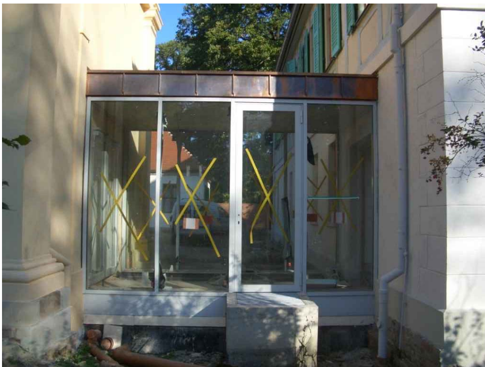
Einbau einer verglasten Stahlkonstruktion als Verbindungsgang zwischen Gastraum in der Orangerie und Küche im neben liegenden ehemaligen Forsthaus. Foto Michael Wetzel
