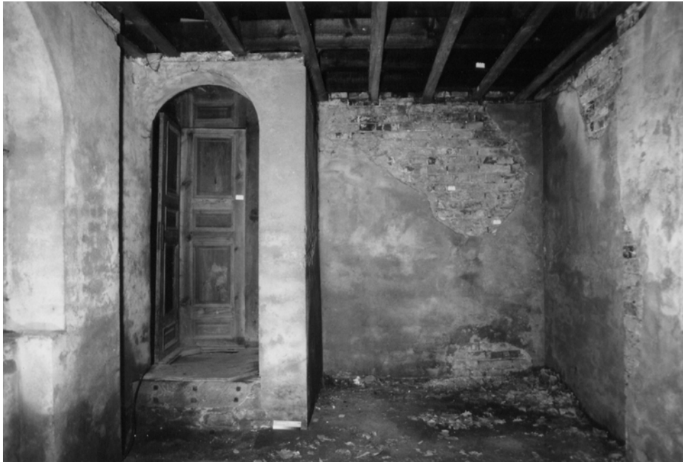
Luisenklippe 2002, Vorzustand des Erkerzimmers. Foto pmp
