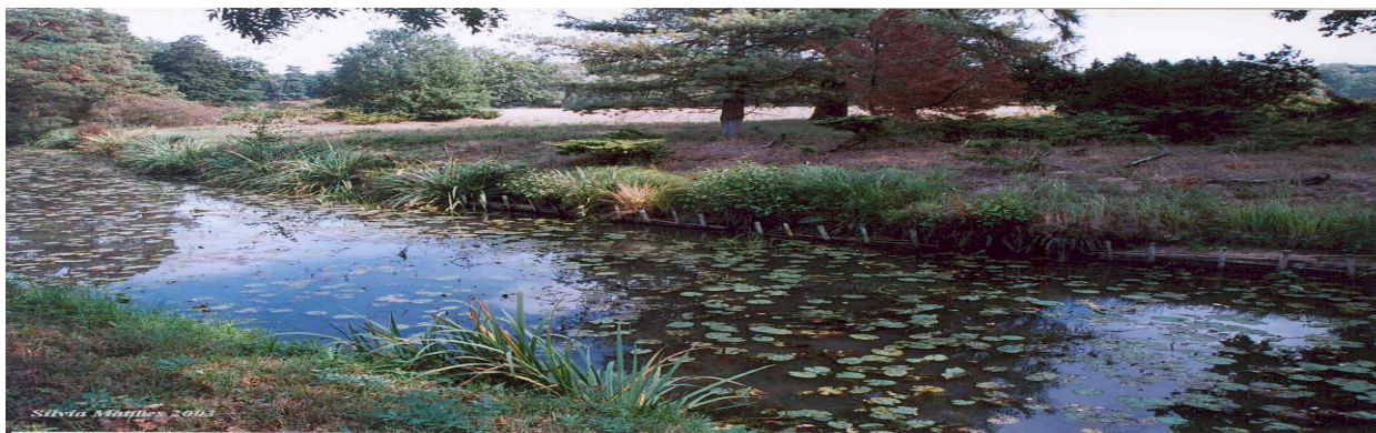
Ausgespülter Nadelholzfachsinenverbau mit teilweisen Auskolkungen der Uferböschungen. Foto Silvia Matthes
