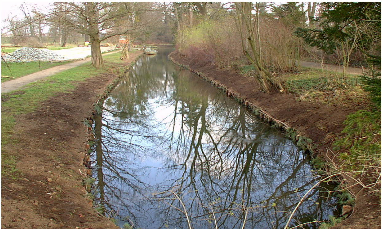
Abgeschlossene Uferinstandsetzung einschließlich Böschungsprofilierung des Kanalabschnittes 2 von der Kettenbrücke bis Platanenallee. Foto Horst Woche
