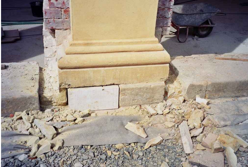
Sandsteinerergänzungen 2004 am südlichen Fassadensockel und an Pilasterfüßen an allen Hausecken. Foto Michael Wetzel
