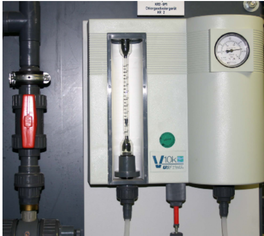
Abb. 4.6: Dosieranlage für Chlor
