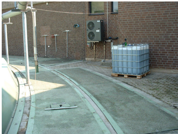
Abbildung 5-3: LIPISOL-Dosierfass und -pumpe im Zulauf zur 1. Kaskade der B-Stufe der Kläranlage Neuss-Ost
