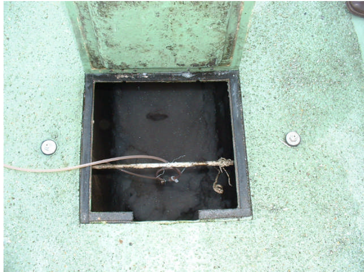
Abbildung 5-4: LIPISOL-Dosierstelle im Zulauf zur 1. Kaskade der B-Stufe der Kläranlage Neuss-Ost
