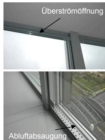
Abbildung 70 Abluftfassade Überströmöffnung Abluftabsaugung
