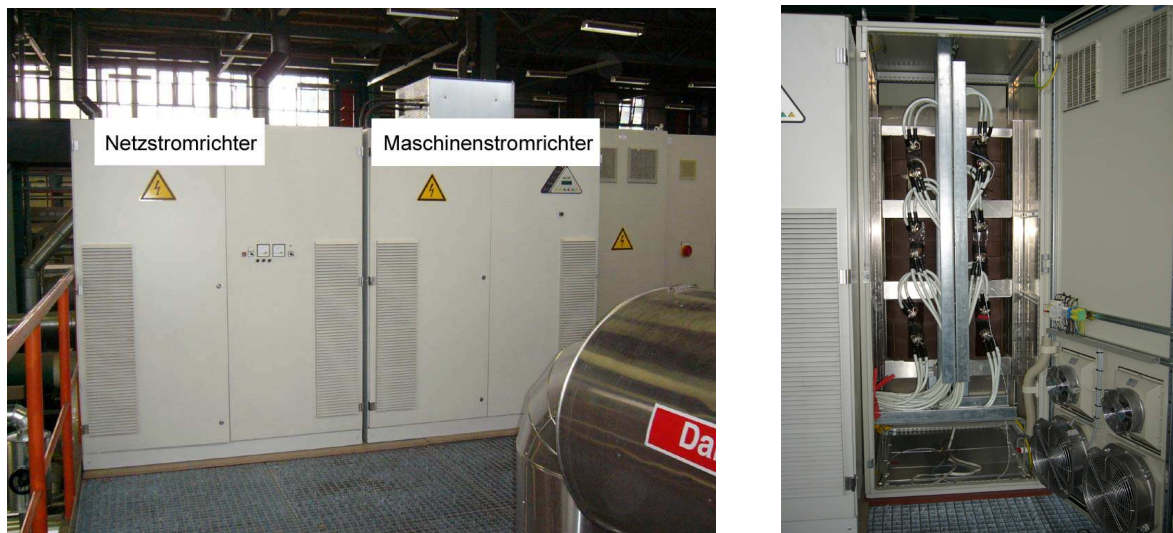
Abbildung 23: Umrichter im HKW Dresden – Reick, Schaltschrank mit Phaseninduktivitäten
