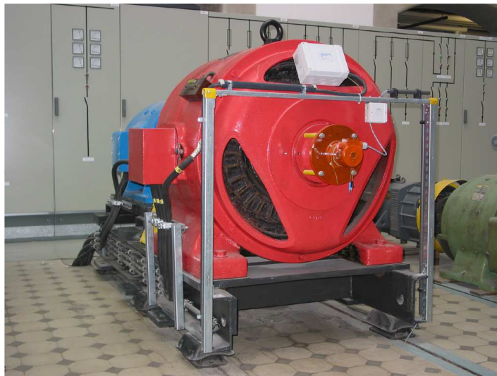
Abbildung 20: Maschinensatz, Gleichstrommaschine (blau), fremderregter 500 Hz – Synchrongenerator (rot)
