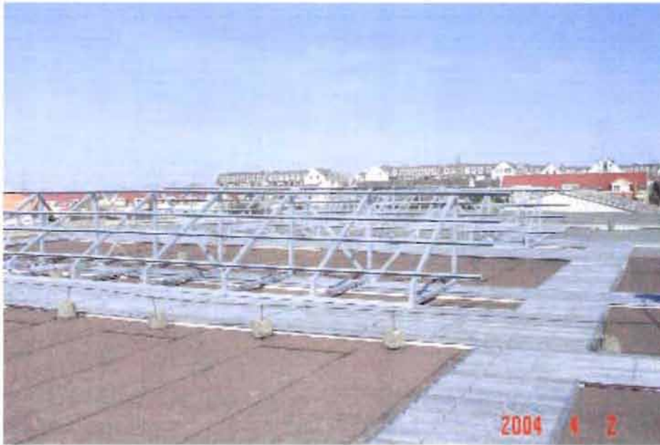
Abb. 3.3: Traggestelle für die Solarmodule (Bildquelle: Universität Debrecen)
