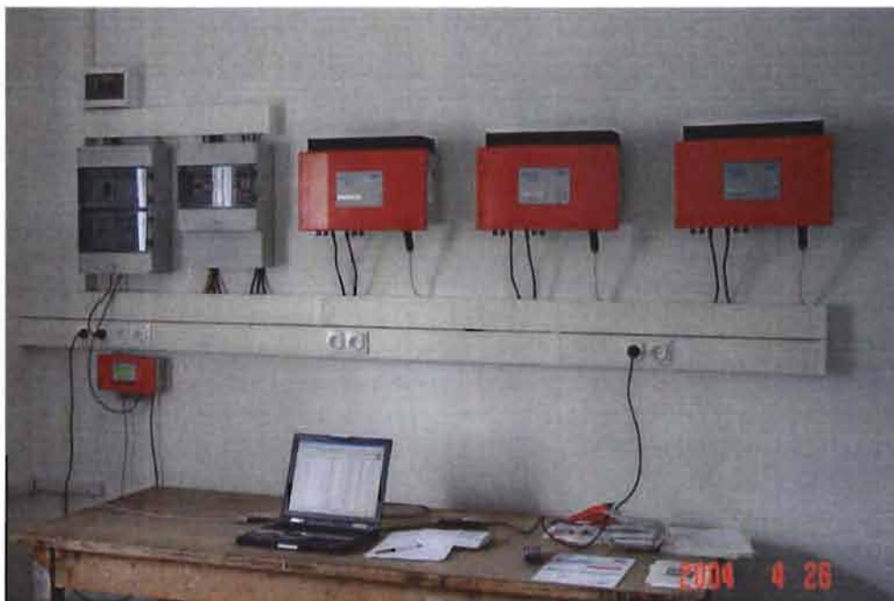
Abb. 3.9: Technikraum mit Wechselrichter (Bildquelle: Universität Debrecen)
