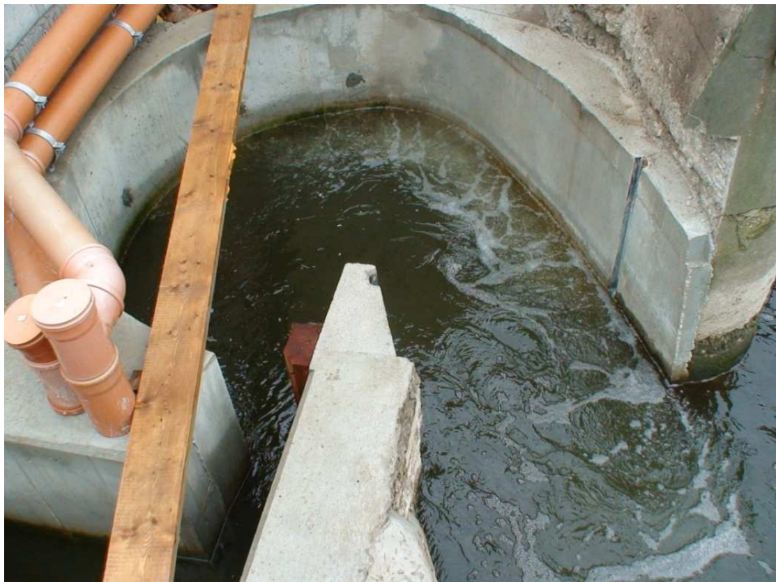
Foto 30: Vorbecken mit Leitströmungsverstärkung in Betrieb
