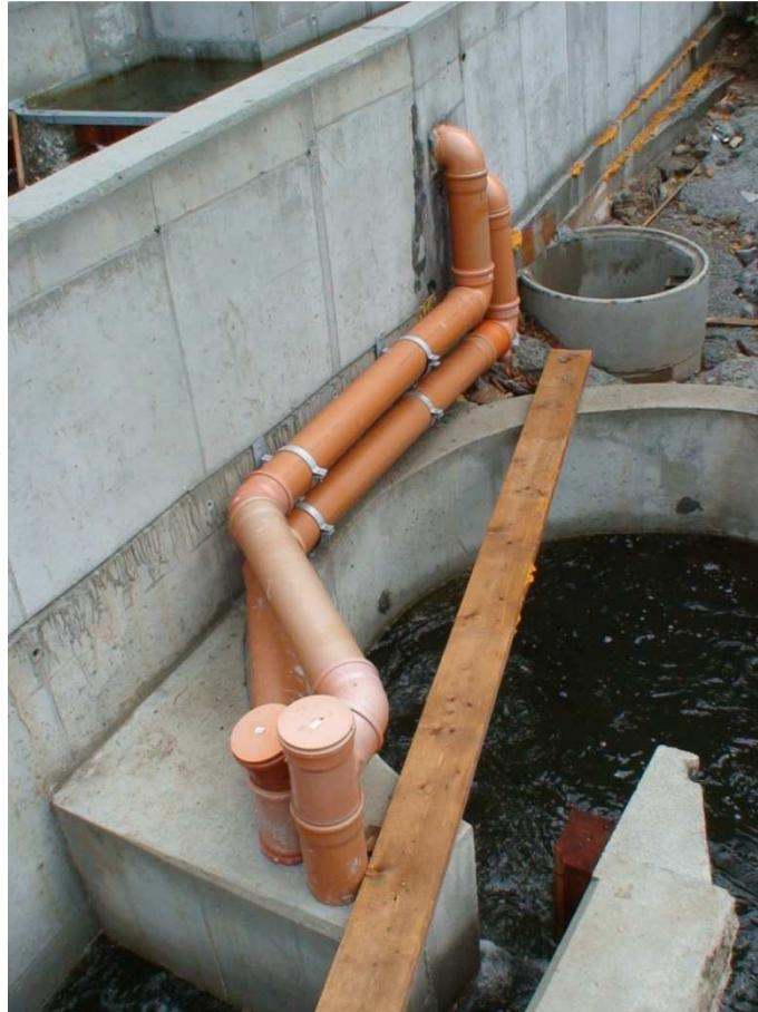
Foto 31: Rohrsystem für die Leitströmungsverstärkung (Entnahme aus dem Kanal)
