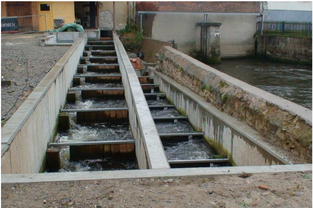
Foto 28: Schlitzpass in Betrieb
