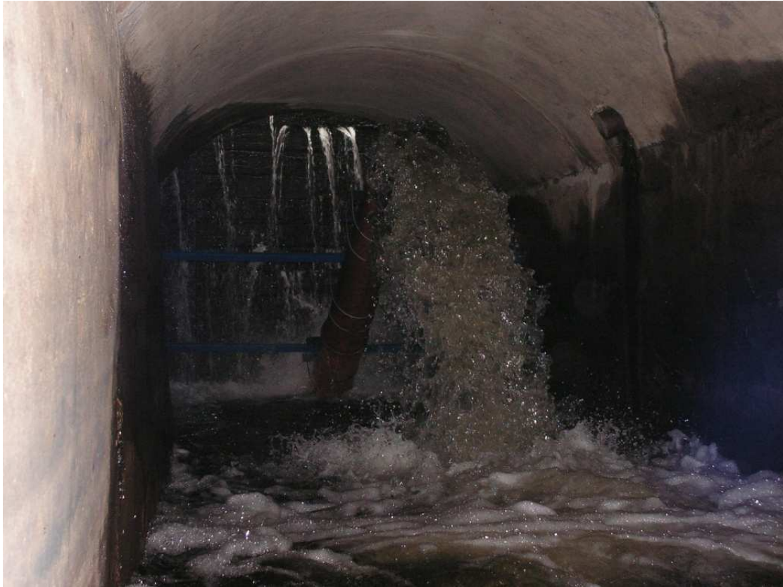
Foto 19: Bypass in Betrieb
