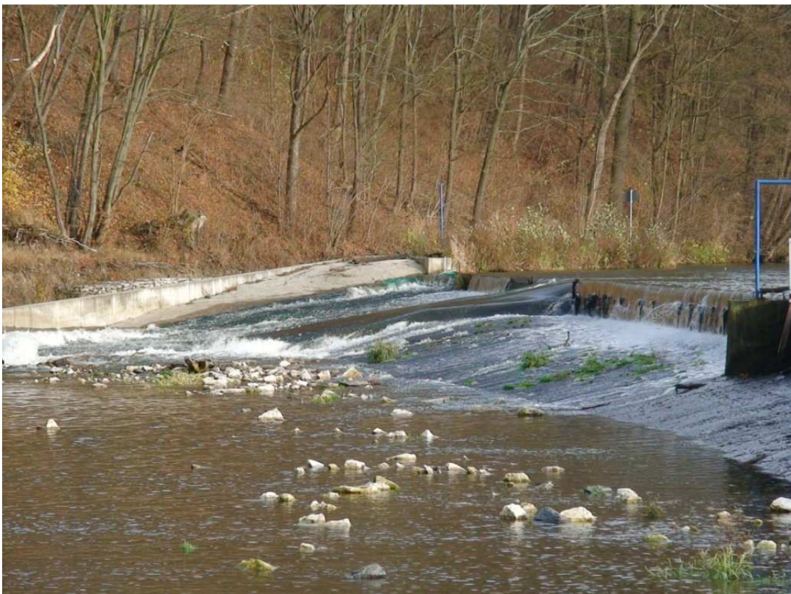
Foto 52: bei einem Abfluss von 25 \text{ m}^3/\text{s} in der Mitte geöffnetes Wehrfeld, keine quantitativen Fänge am Wehr möglich
