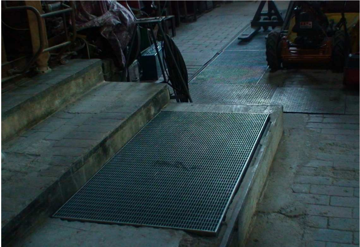
Foto 27: Gitterroste im Betriebsgebäude zur Abschwächung der Verdunkelungswirkung
