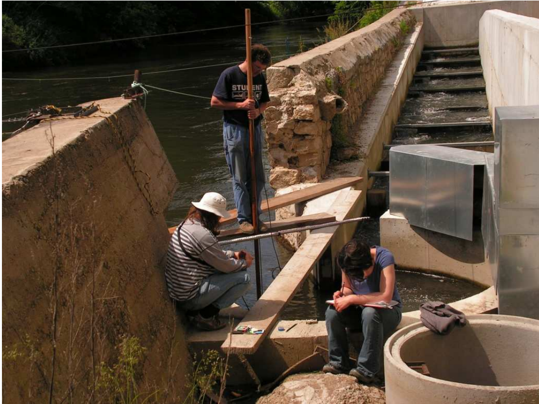
Foto 55: Messung der Fließgeschwindigkeit im Auslaufbereich des Vorbeckens
