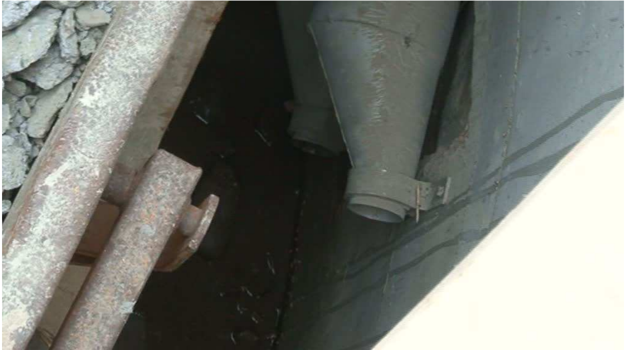
Foto 23: Lockstromdüsen im Rundbecken
