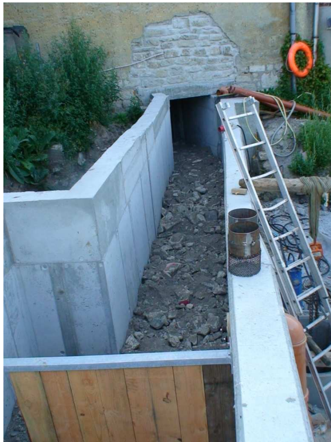
Foto 26: Eingang des Schlitzpasskanals in das Betriebsgebäude
