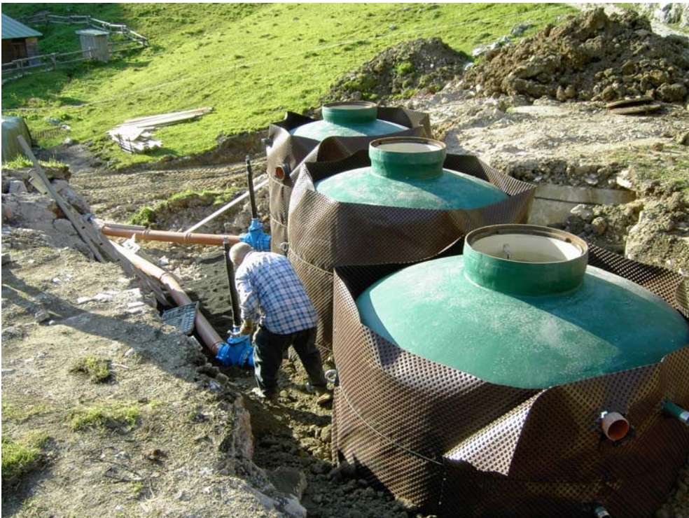
Absetzbecken und Beschickerschacht mit Schieber
