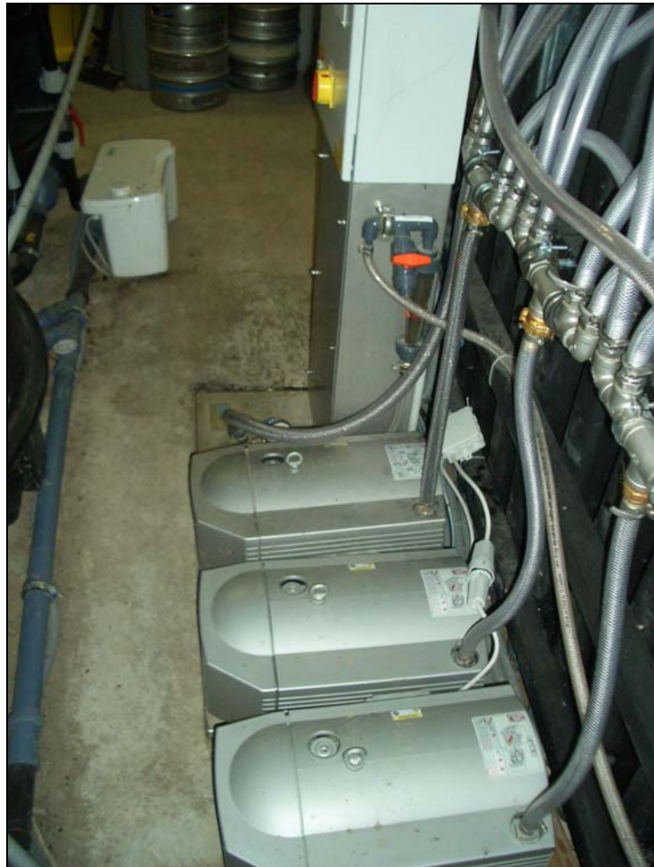
Bild 10: Belüfteraggregate der biologischen Stufe
