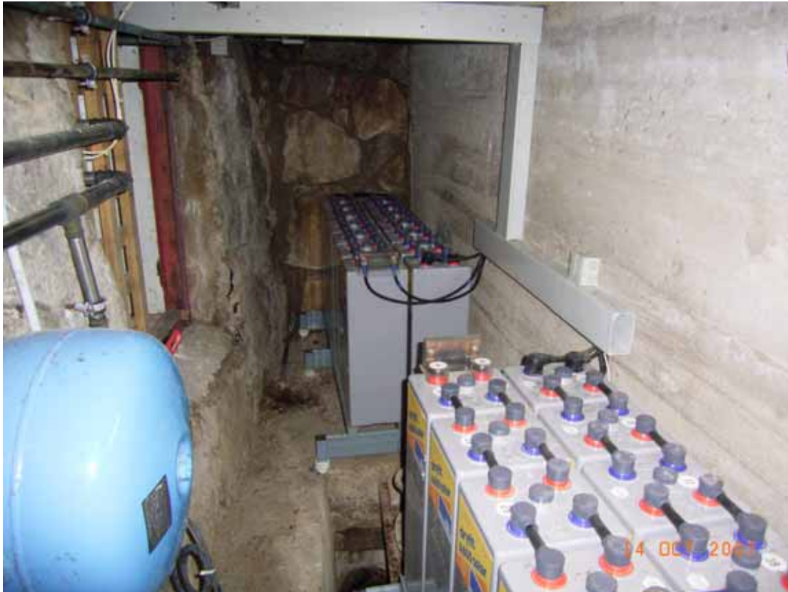
Abbildung 3: 30 Blei-Gel-Akkus Sonnenschein Dryfit A600 solar 10 OpzV 1200 mit 6 Jahren Vollgarantie
