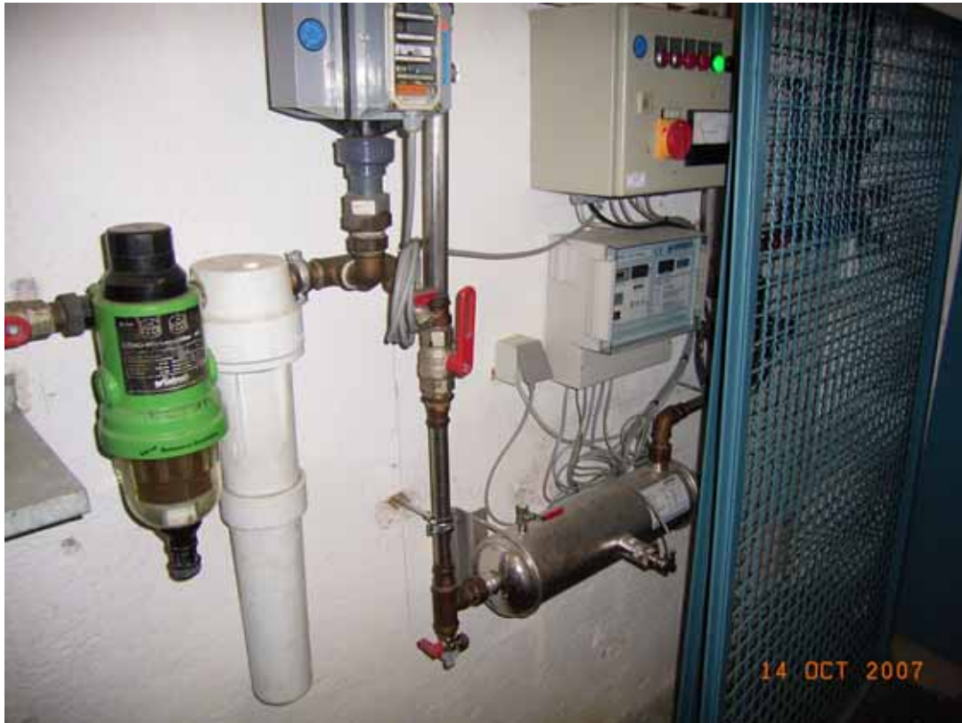
Abbildung 10: UV-Entkeimungsanlage mit vorgeschaltetem Feinfilter
