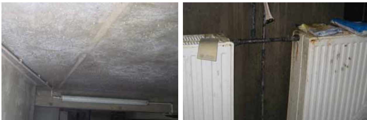
Abbildung 16: Starke Kondensatbildung an der Klärraumdecke (links) und Schädigung der Heizungsinstallation im Klärraum (rechts)
