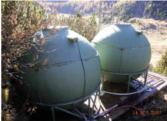
Abbildung 9: Hochbehälter der Wasserversorgungsanlage
