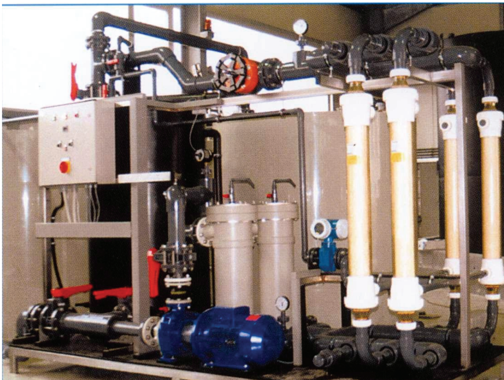
Abbildung 12 : Industrielle Ultrafiltrationsanlage der Pilotanlage mit 6 Modulen.
