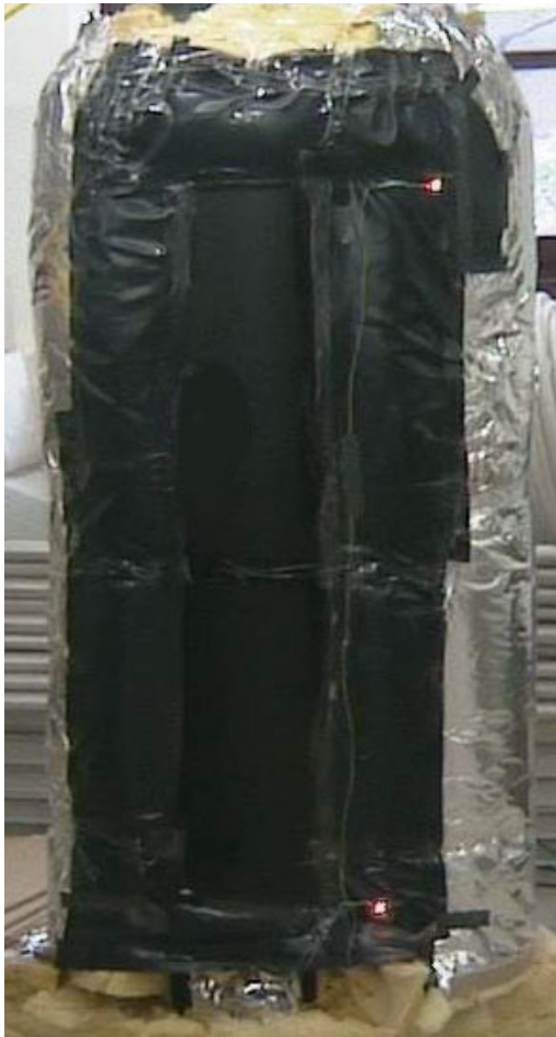
Bild 19 Speicher mit ungedämmtem Ausschnitt zur IR-Messung
