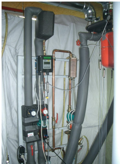
Bild 104 Messaufbau der Sole/Wasser-Wärmepumpe mit speicherintegrierter Enthitzerschleife und Kondensator, Heizkreis und Warmwasserbereitung – Laborversuch Solvis
