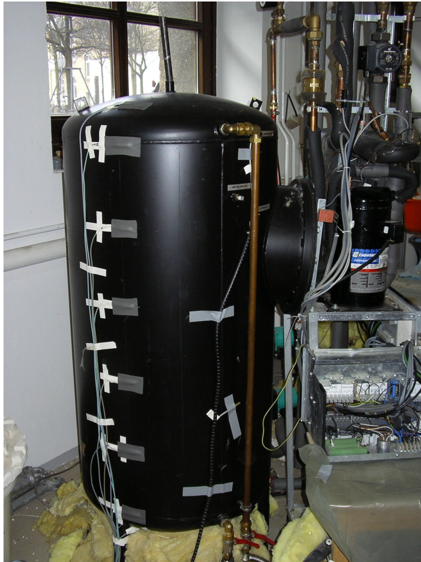
Bild 97 Messaufbau der Sole/Wasser-Wärmepumpe mit speicherintegrierter Enthitzerschleife und externem Kondensator – Laborversuch IGS
