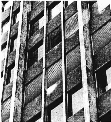
Gebäudeansicht vor der Sanierung und Zustand der Stahlträger mit Korrosionsschäden.
