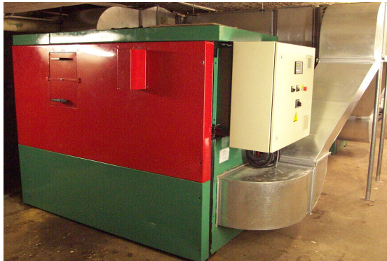
Abb. 9.2.3.6-1 BHKW im LWH
