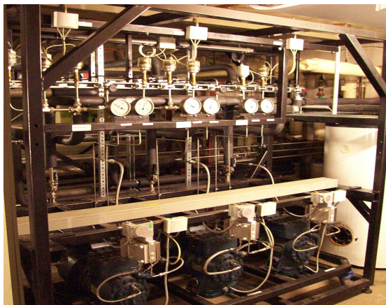
Abb. 9.2.3.5-3 Wärmepumpe im LWH
