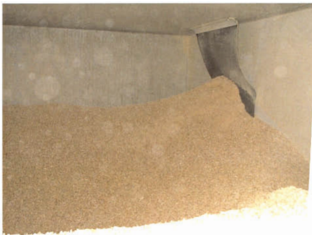
Abb. 36: Holzpelletslager mit Gummimatte als Aufprallschutz
