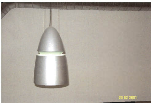
Abb. 50: Pendelleuchte mit Halogenmetaldampfleuchte im Treppenhaus
