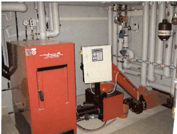
Abb. 35: Heizzentrale mit Holzpelletsheizkessel
