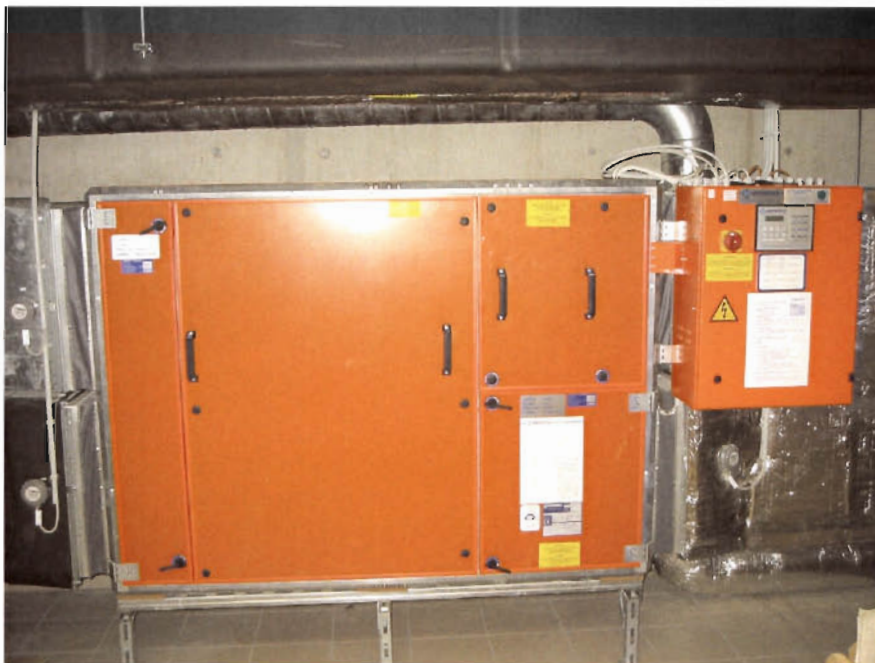
Abb. 40: Lüftungszentralgerät im Keller
