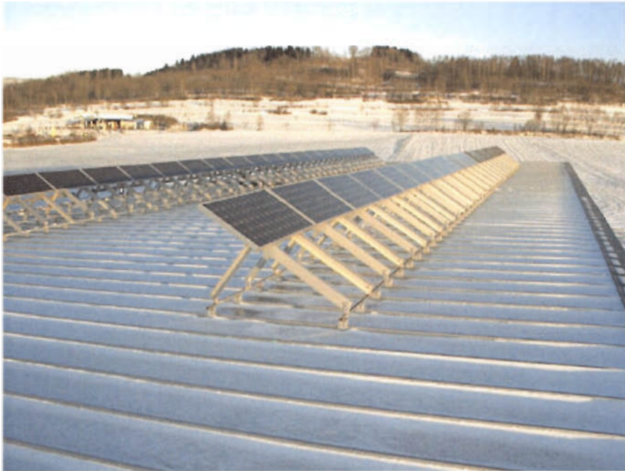
Abb. 48: Photovoltaik-Anlage auf dem Dach des Gebäudes
