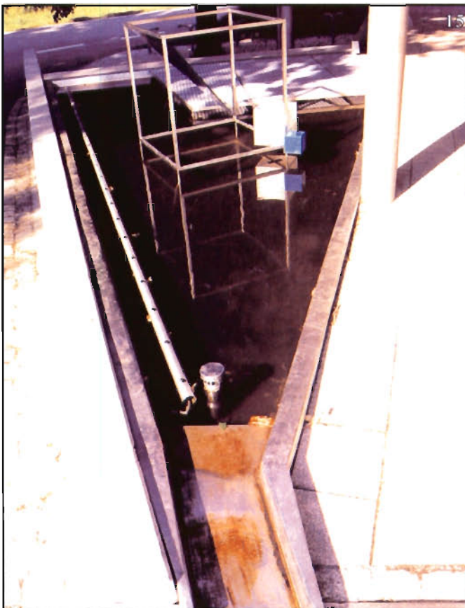
15: Das Eingangsbecken mit der Nebelsprühanlage und dem globalen Wasserwürfel
