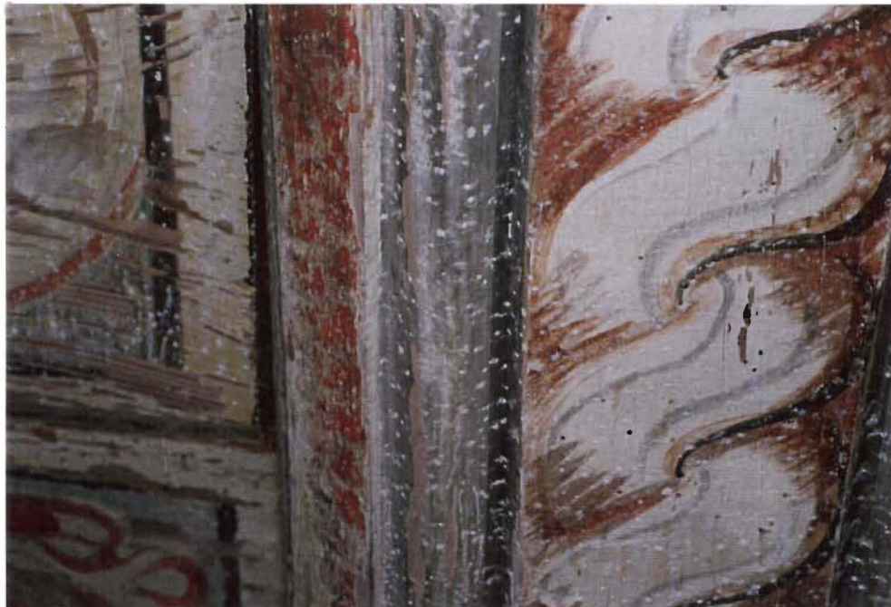
Bild 6; Wirkstoffausblühungen auf der Holzbalkendecke der Kirche Blochwitz
