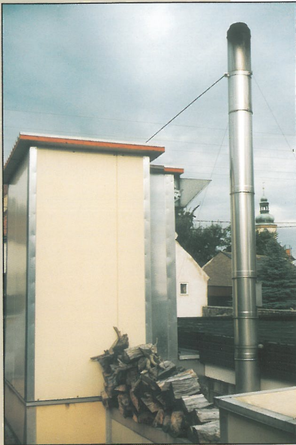
Abgaskamin der Holzreste-Feuerungsanlage
