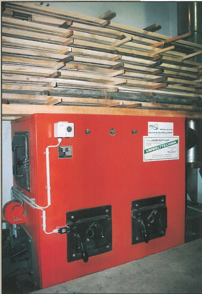
Holzreste-Feuerungsanlage Fabr. Heizomat
