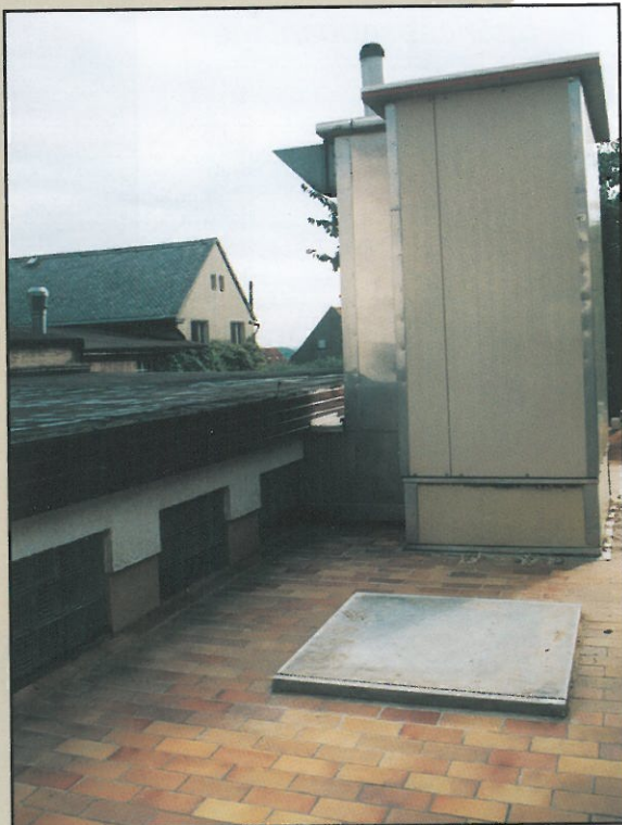
Späne-Flachbunker mit Filteranlage für das abgesaugte Späne-Luft-Gemisch
