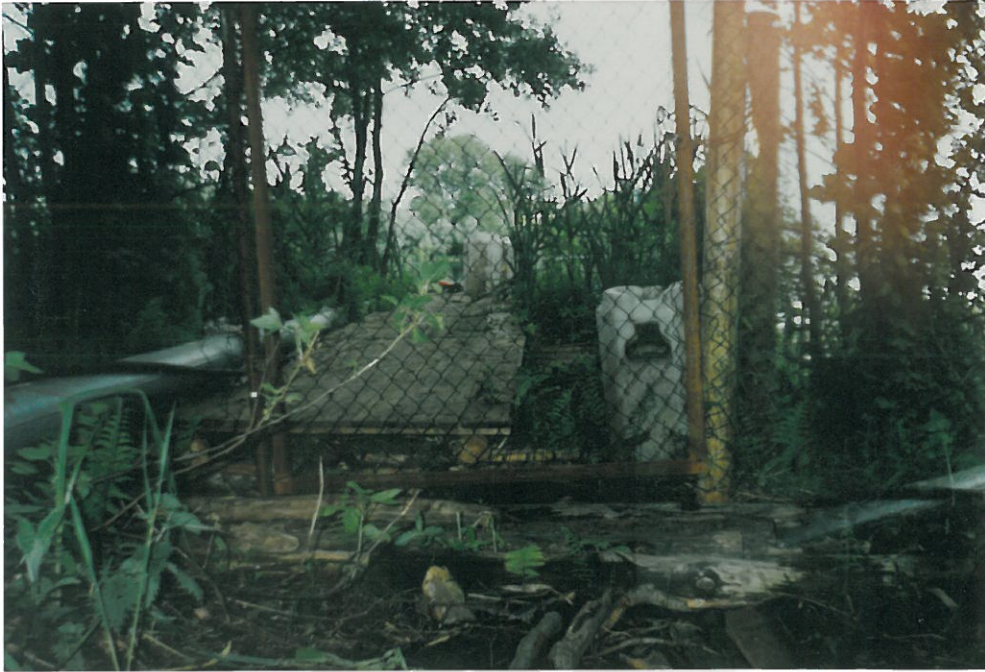
Bild 7: Druckleitung im Auwald
