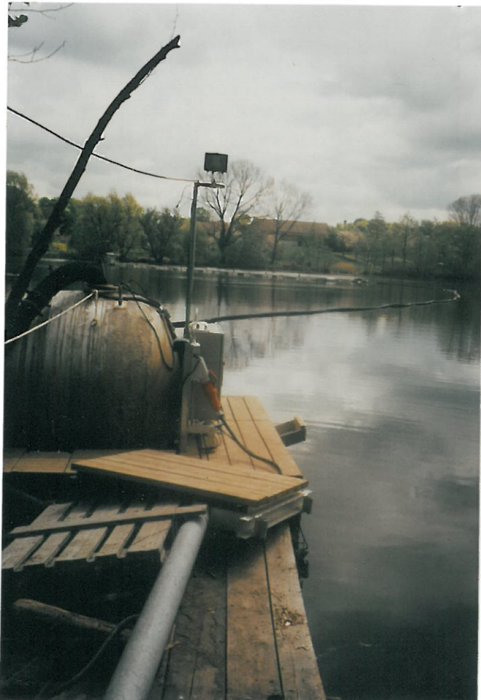
Bild 10: Schwimmende DEST mit Verbindungsleitungen
