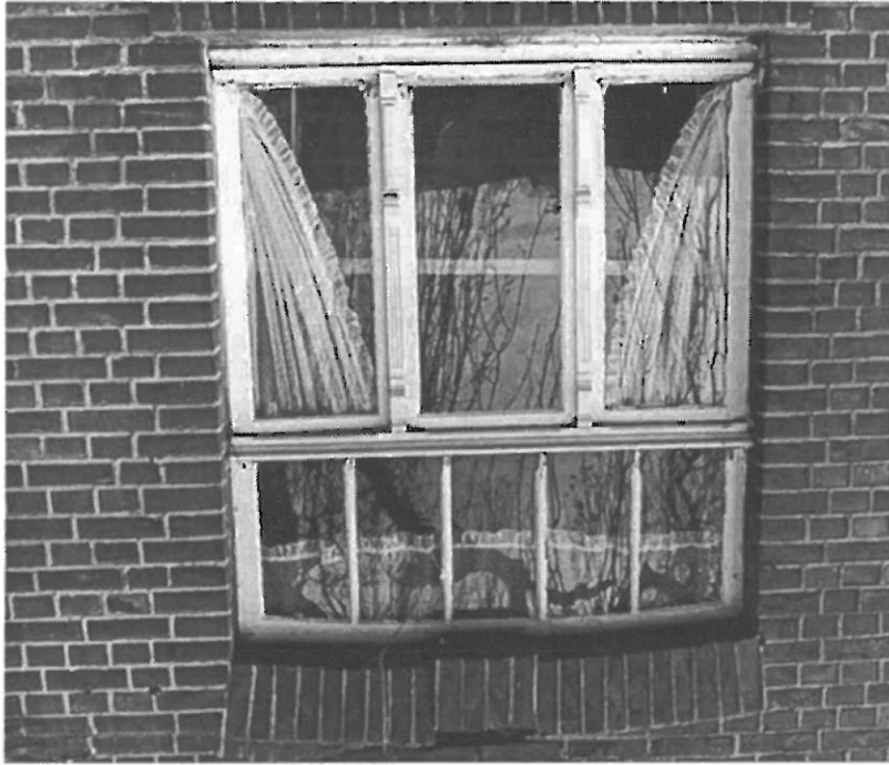
Die Ansicht des gleichen Eichenfensters von aussen mit dem beschädigten Sturzbojen des Mauerwerks.
