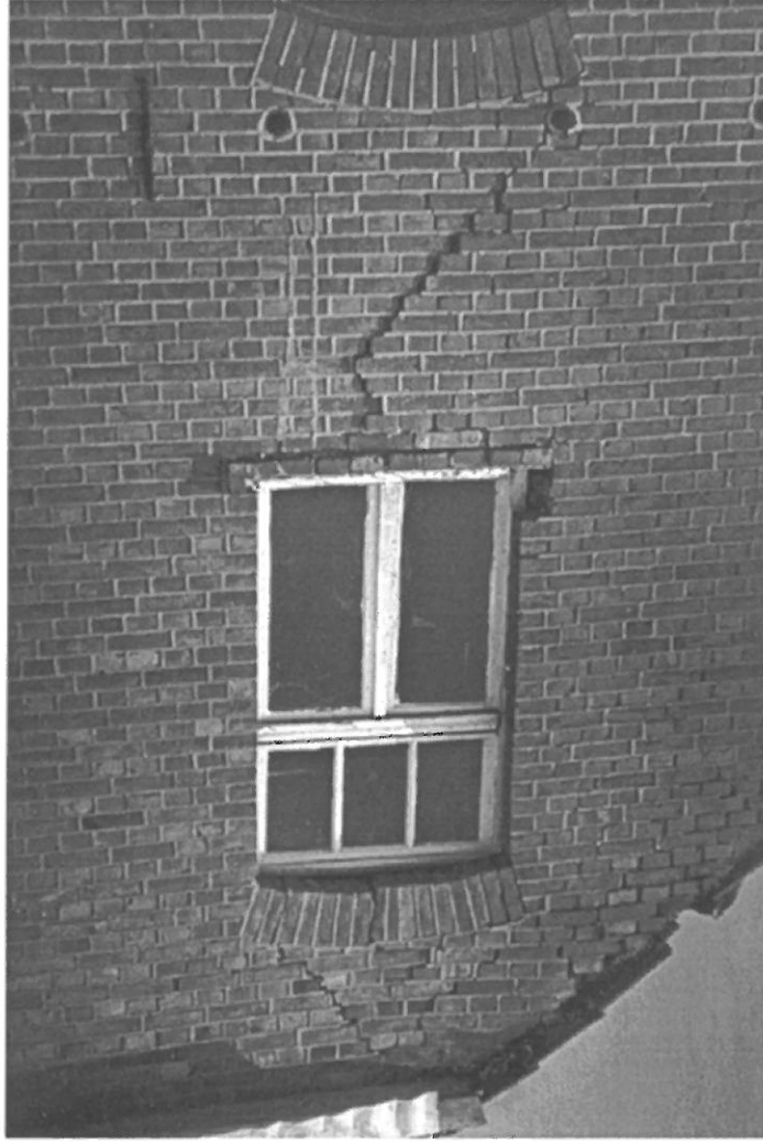
Besonders die Fassaden des Stallgebäudes wiesen enorme Rissbildungen, sowohl durch Setzungen, als auch durch unsachgemäße Reparaturarbeiten, auf.
