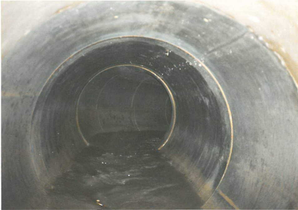
Bild 69: Innenwand des Torsionskompensators
