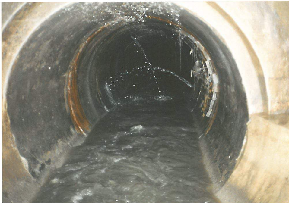
Bild 20: Infiltration von Grundwasser im Unterwasser des Drehbogens
