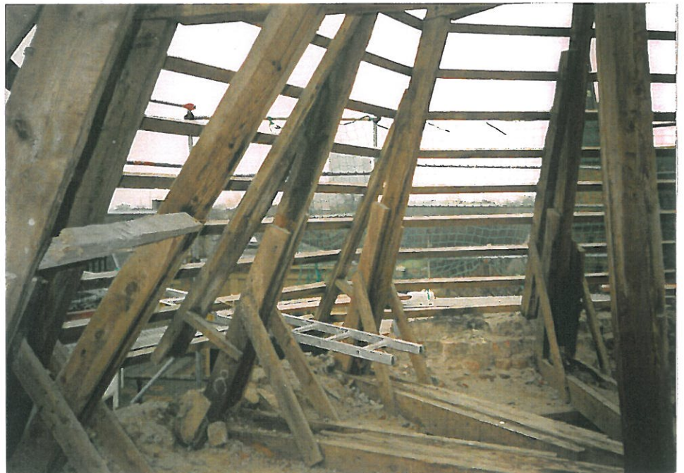
zerstörter Dachstuhl + Traufe
